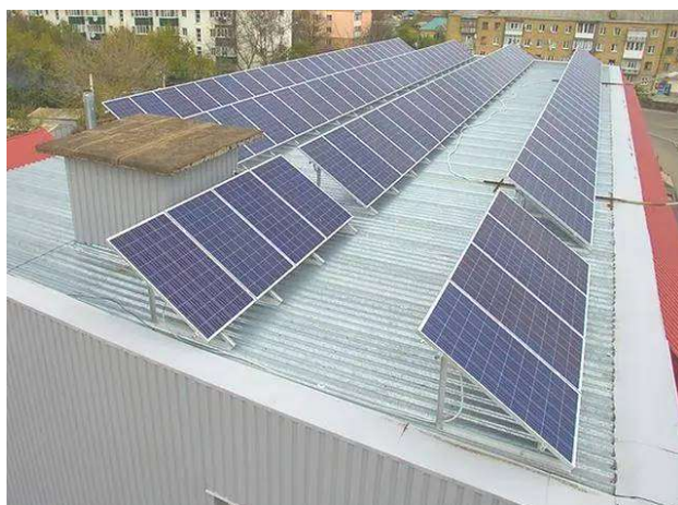
Рис. 2. Розміщення сонячних панелей на даху будівлі
