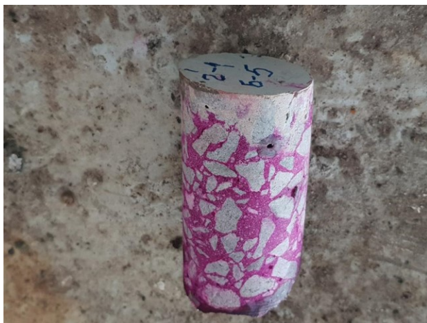
Рис. 3. Керн вибурений з тіла бетону балки біля опори. Карбонізація бетону на глибину до 20 мм.
